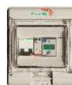
PAINEL DE PROTEÇÃO AC (LT)
