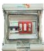
DC AJB (Sistema de proteção DC)
