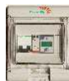
PANEL DE PROTECCIÓN AC (LT)
