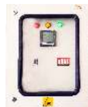
PANEL DE PROTECCIÓN AC (LT)
